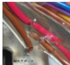
被害痕跡の一例
